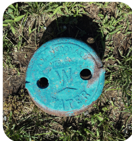
Curb Stop Lid
